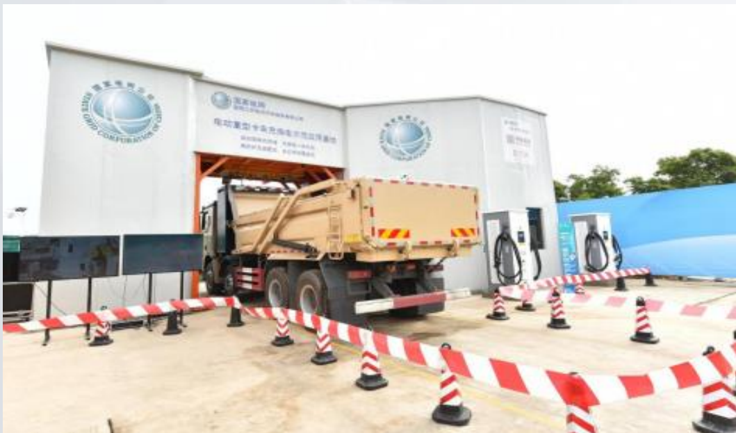
南京市溧水区渣土车换电站
